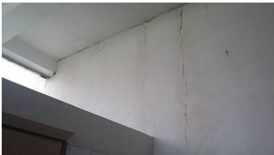
Figura 33 – Locale spogliatoi, particolare lesioni verticali tamponamenti
