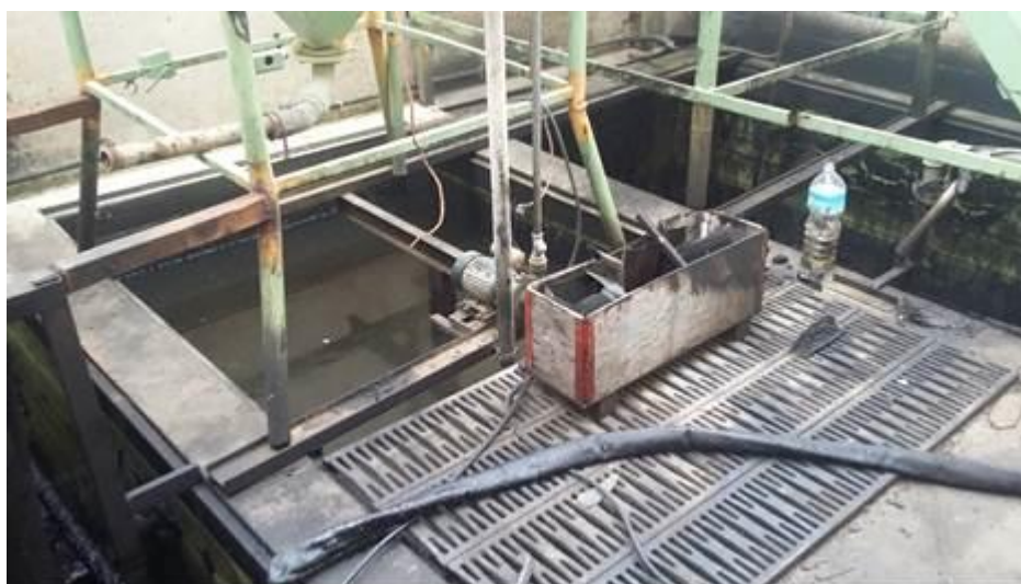
Figura 39 – Depuratore reflui, vasca di disoleazione/decantazione
