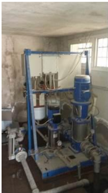
Figura 37 - Locale tecnico – pompe idrauliche
