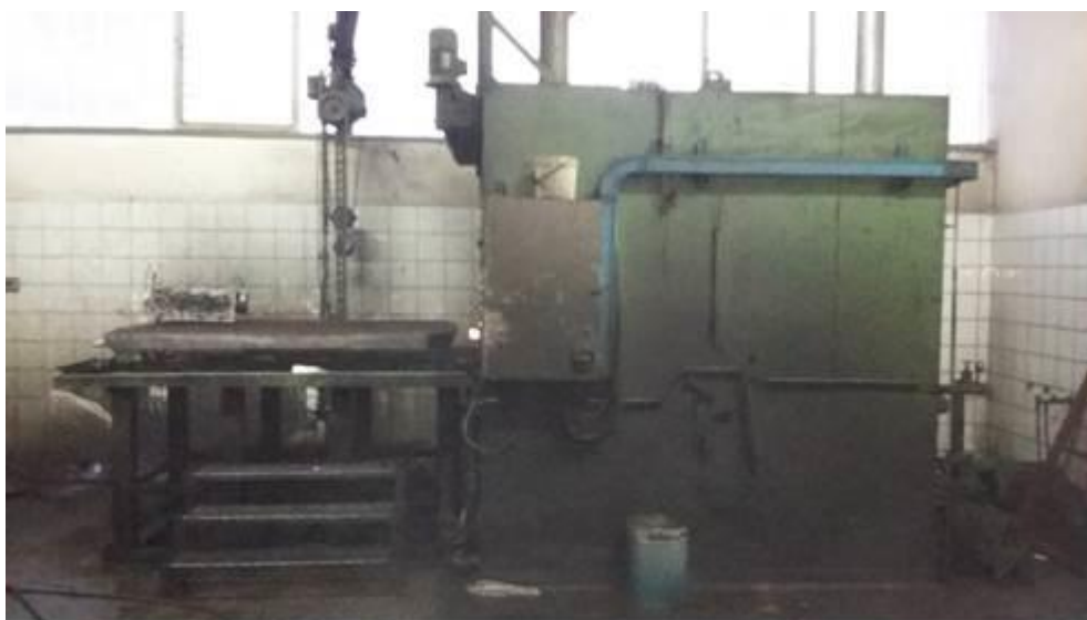
Figura 34 – Sala lavaggio motori
